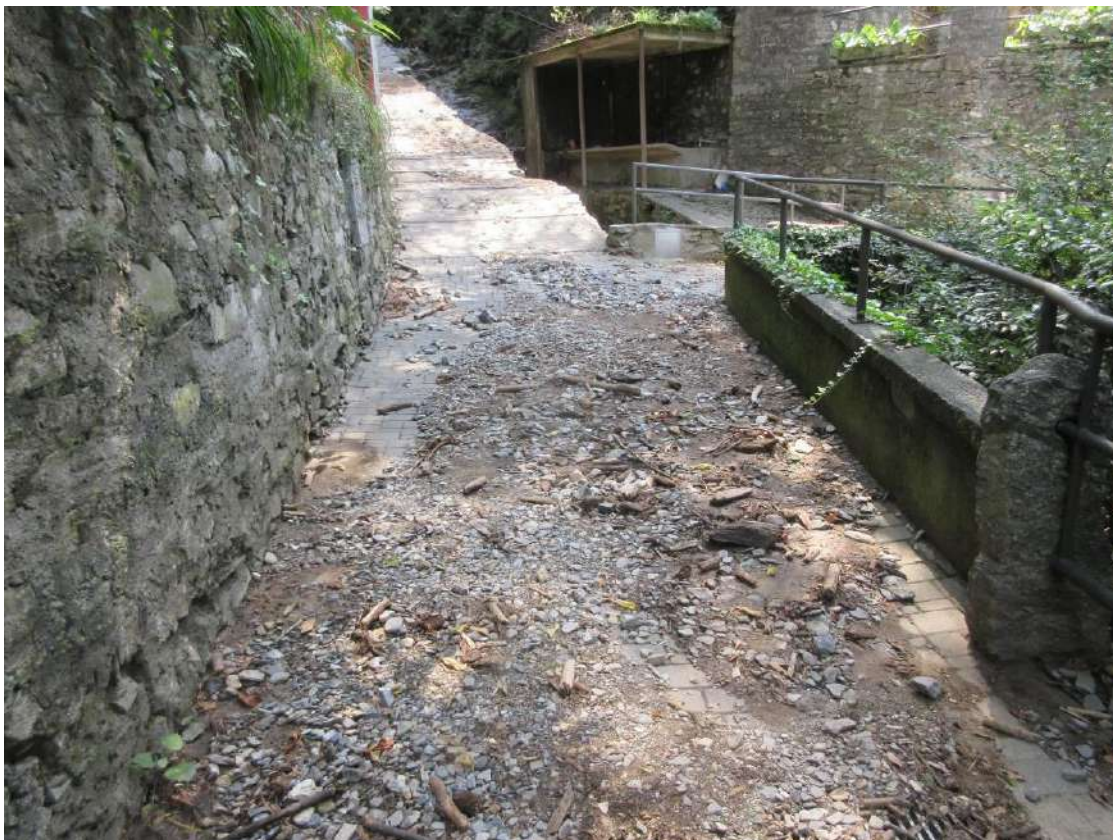
Modesti accumuli di detrito in corrispondenza dell'attraversamento sito all'altezza del lavatoio
